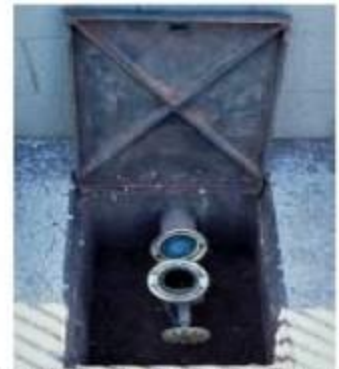
Hidrante de recalque aberto
